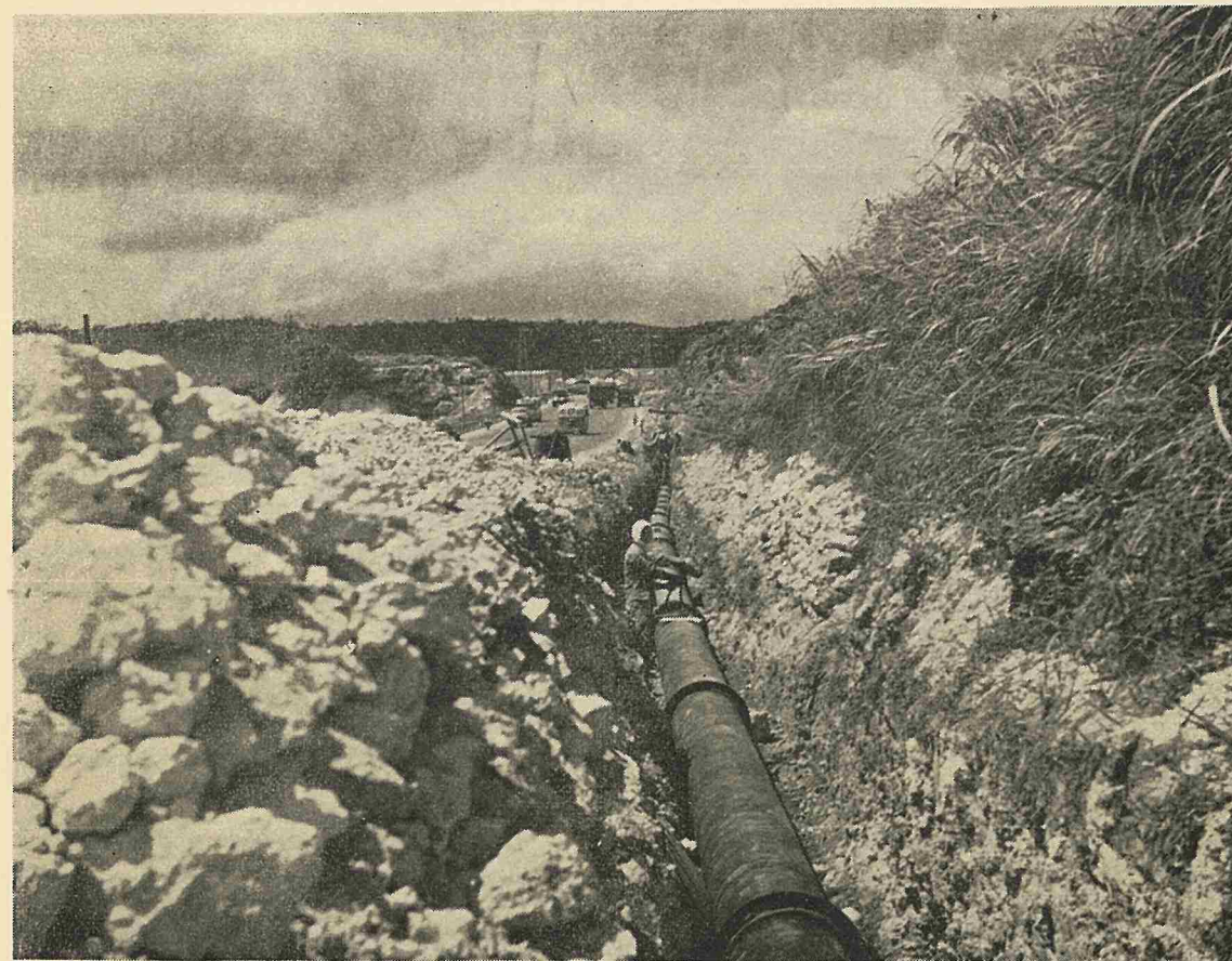
1号線沿の16"本管敷設工事、この本管は嘉数のポンプ場から泊の那覇市浄水所まで伸びている
