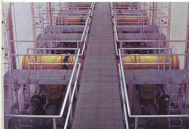
濾過池配管室
