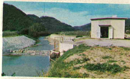
← 源河ポンプ場
