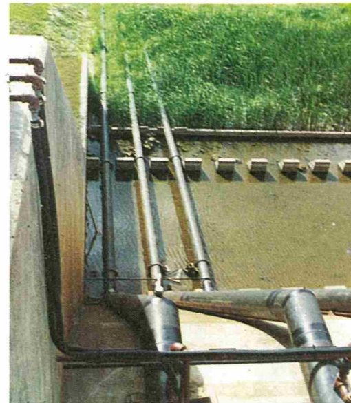
瑞ヶ山ダム—ジャク増圧ポンプ場間の導水管
