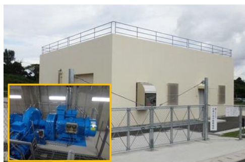
大湾小水力発電施設 (全景と水力発電機)
