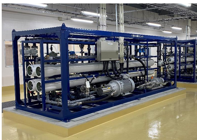
北大東島の海水淡水化施設
