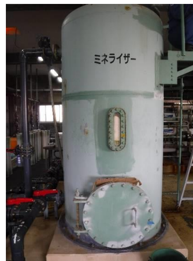
離島海水淡水化施設のミネラル添加槽（外観）
