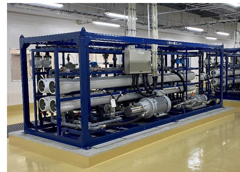
北大東島の海水淡水化施設
