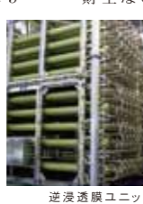
逆流透過ユニット(海水淡水化施設)
