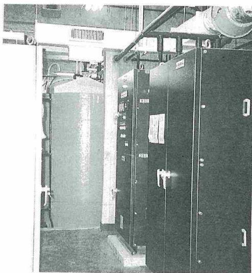
次亜塩素酸ナトリウム注入設備
