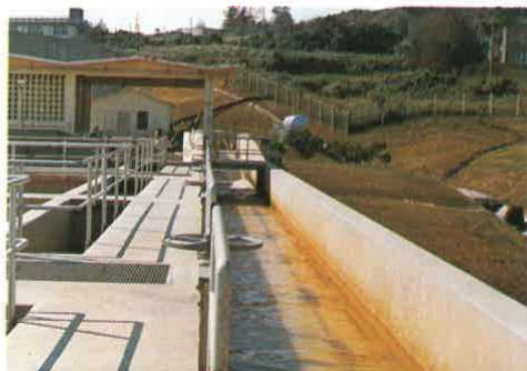
薬品混和水路
