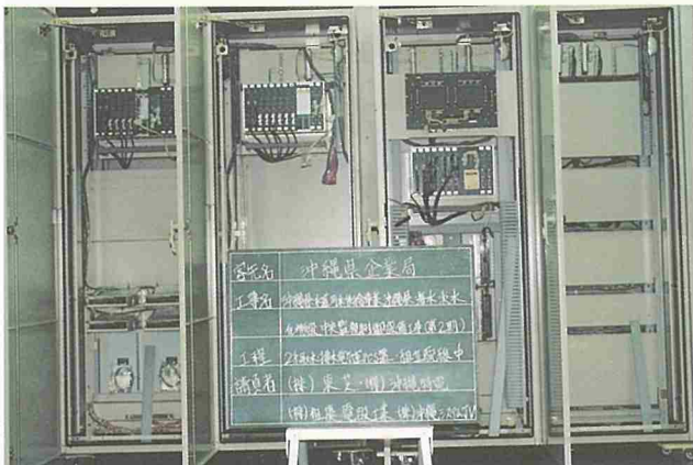
P C S 装置工場製作状況
