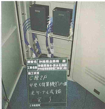
中央計算機室光ケーブル接続完了
