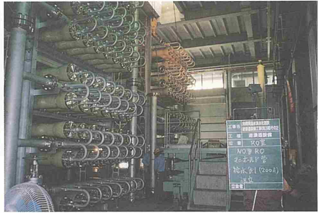
ROユニット廻りの配管接続
