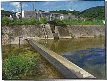
満名取水ポンプ場 (西系列河川)
