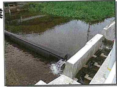
喜如嘉取水ポンプ場 (西系列河川)
