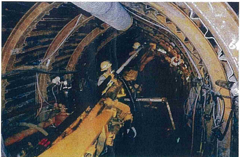
崩落箇所天端補強（長尺ボルト打設、シリカレジン注入）、その他先受け工実施。
