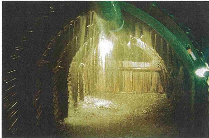
平成 16 年 1 月 8 日 支 No660~No674 区間で突発湧水(約 1000 リットル/min) 土止め柵の設置
