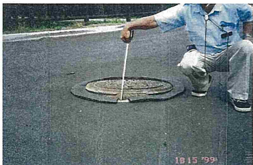
道路のマンホールの浮き上がり 宮城橋手前
