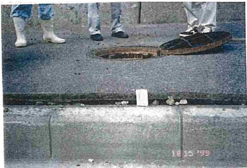
浮き上がった歩道の舗装 (約 10cm) 大宜味中学校前
