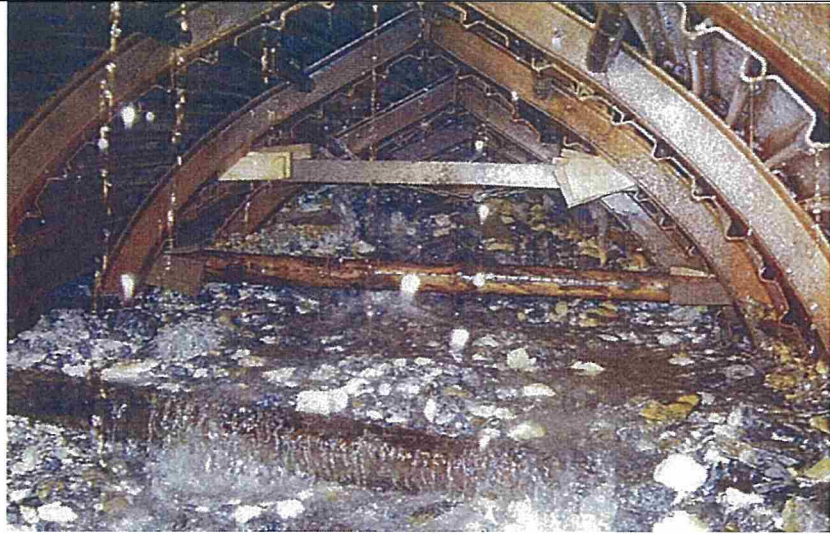
切羽の状況、約 30m 3 の崩落土砂。
