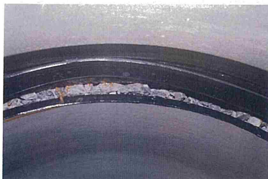
原因となった漏水部
