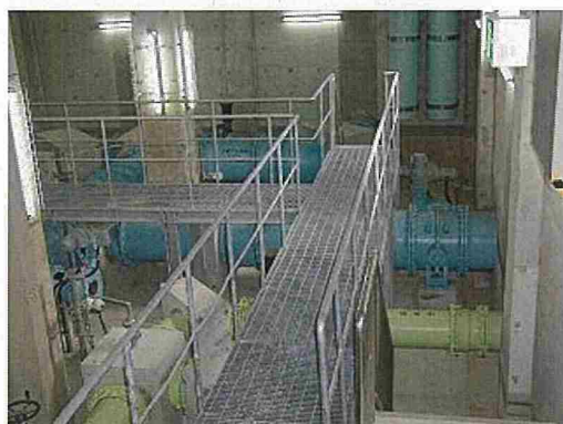
大保流量制御弁室 内部
