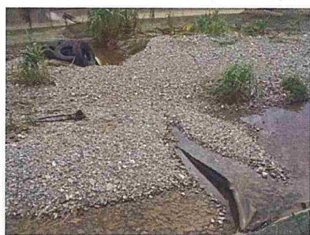
西屋部川堆積土砂（除去前）
