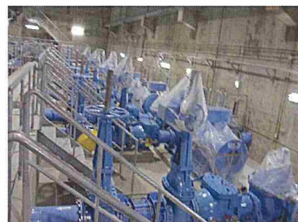
大保取水ポンプ場 内部概観
