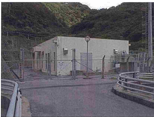
辺野喜取水ポンプ場
