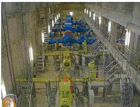
許田増圧ポンプ場内部
