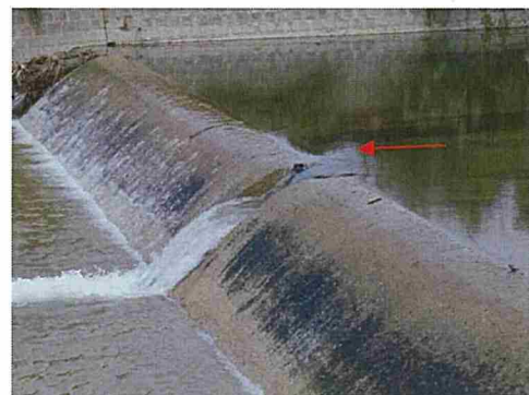
比地川取水堰 切り欠きからの越流状況
