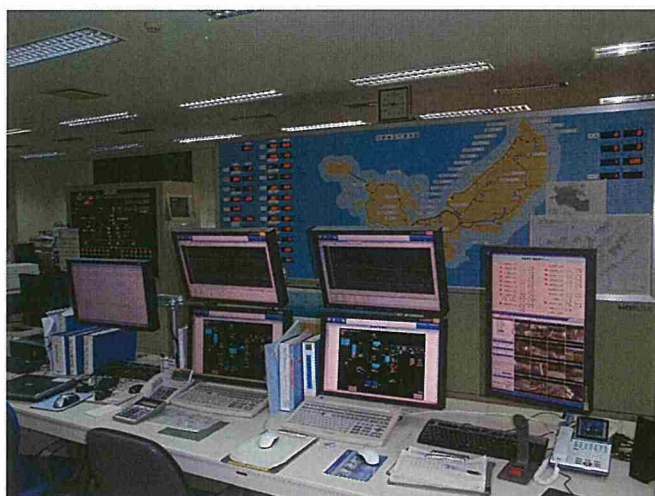
久志浄水場中央監視室
