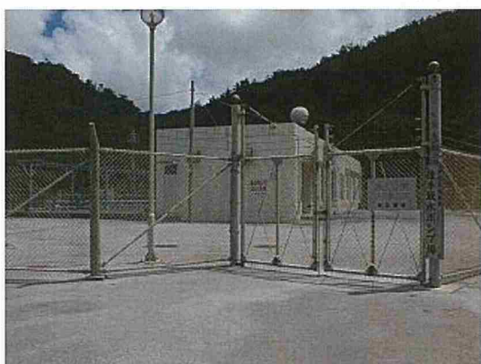
佐手取水ポンプ場
