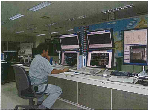
中央監視制御室
