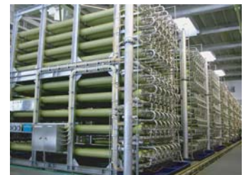
(写真) 海水淡水化センターの心臓部にあたる逆浸透設備
