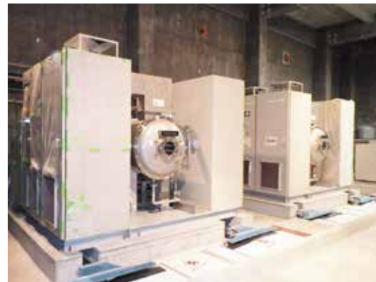
(写真) オゾン発生器改良後
