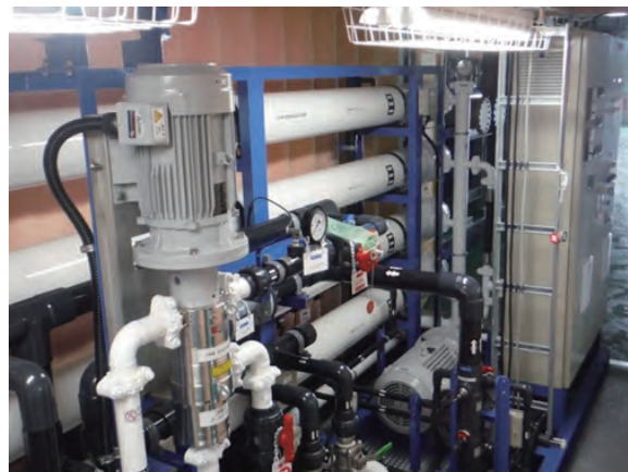
海水淡水化装置（コンテナ内）
