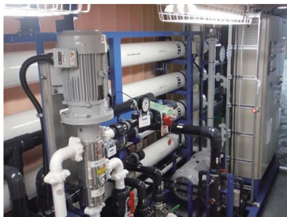
海水淡水化装置（コンテナ内）
