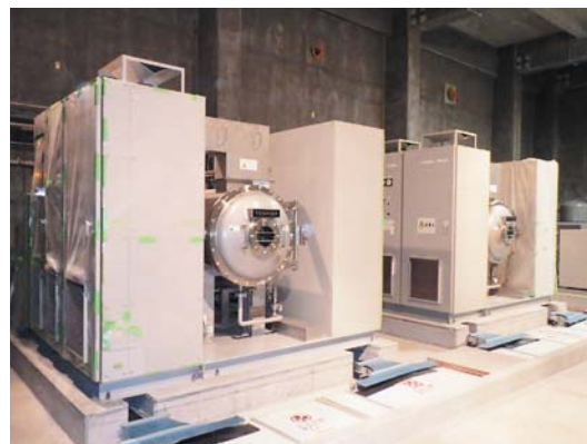
(写真)オゾン発生器改良後
