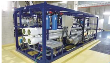
伊是名浄水場(逆浸透膜 後処理)
