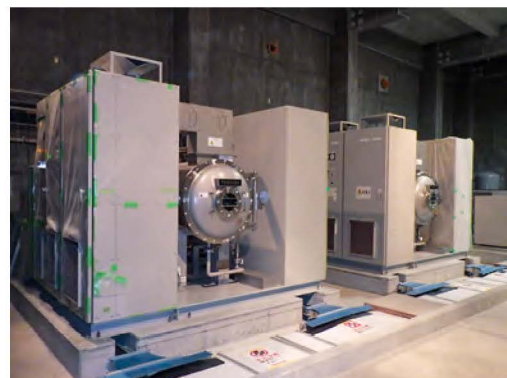
オゾン発生器改良後
