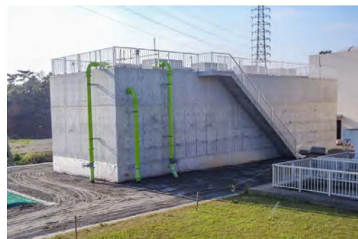
活性炭施設(新設)
