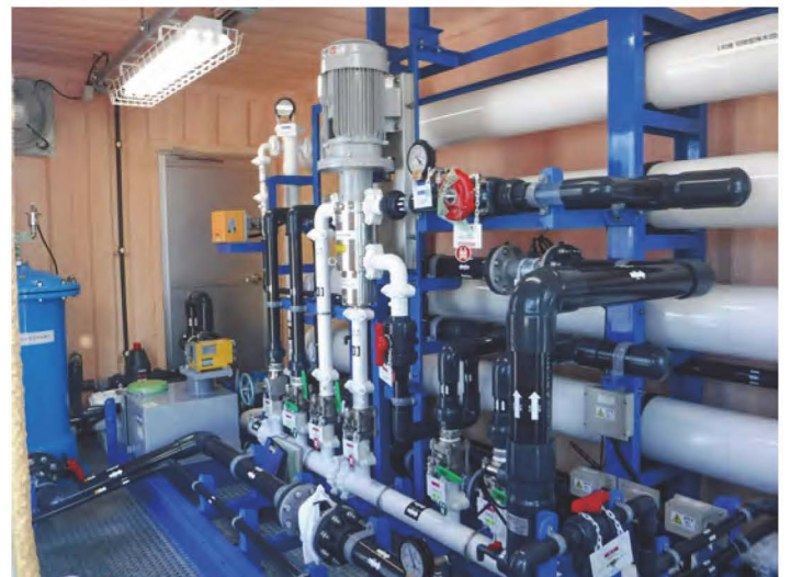
海水淡水化装置(コンテナ内)
