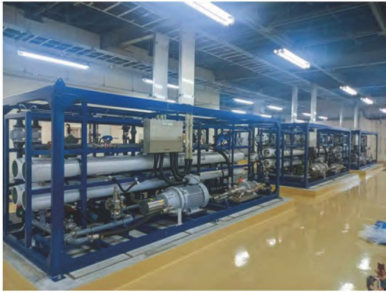
南大東浄水場(逆浸透設備)
