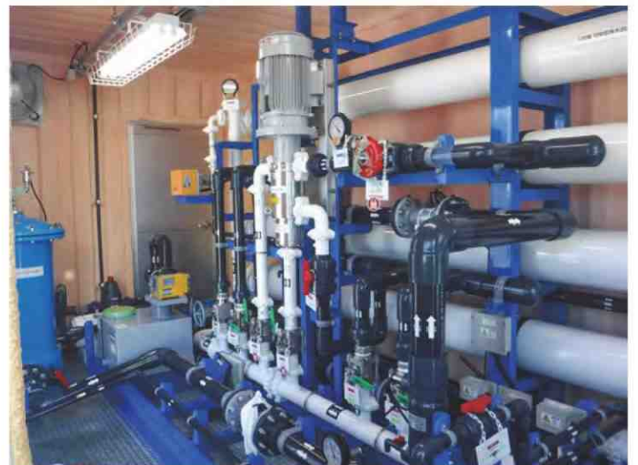
海水淡水化装置(コンテナ内)
