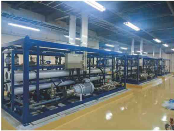
南大東浄水場(逆浸透設備)
