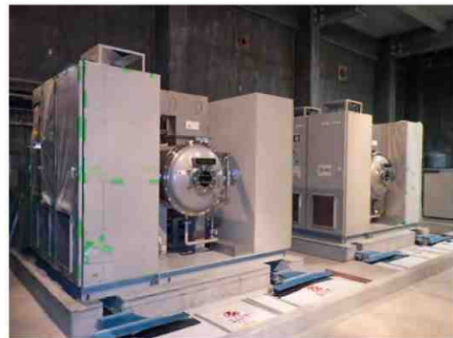
オゾン発生器改良後
