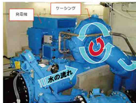
小水力発電設備
