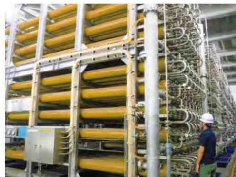
海水淡水化センターの心臓部にあたる逆浸透設備
