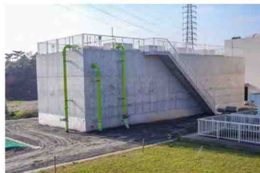
活性炭施設(新設)
