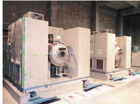
(写真)オゾン発生器改良後
