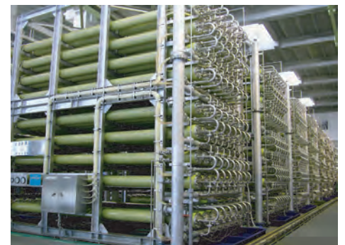
(写真) 海水淡水化センターの心臓部にあたる逆浸透設備
