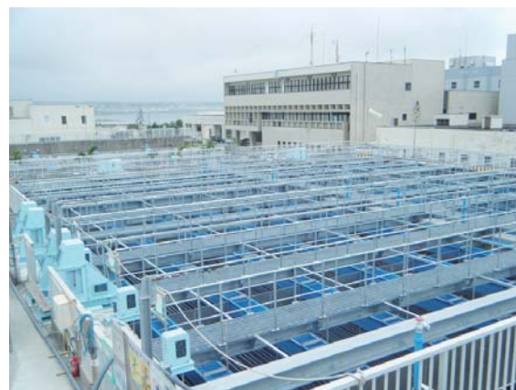
沈澱池改良後（傾斜管）
