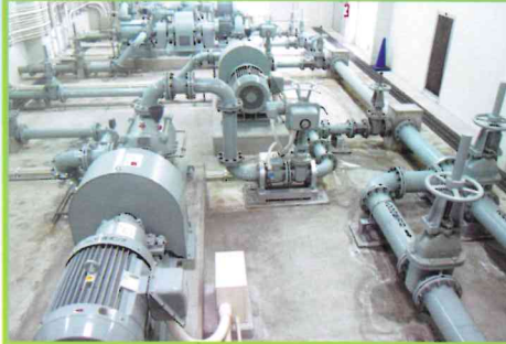
小那覇増圧ポンプ設備
