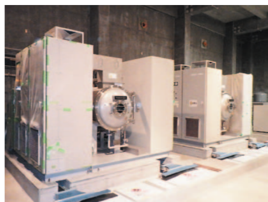
(写真)オゾン発生器改良後
