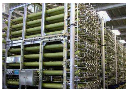
逆浸透膜モジュール(海水淡水化施設)
