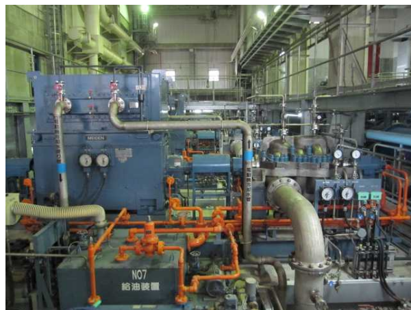
動力回収タービン(海水淡水化施設)
