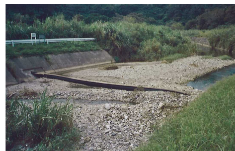
取水堰の堆積土砂状況
