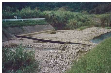
取水堰の堆積土砂状況
