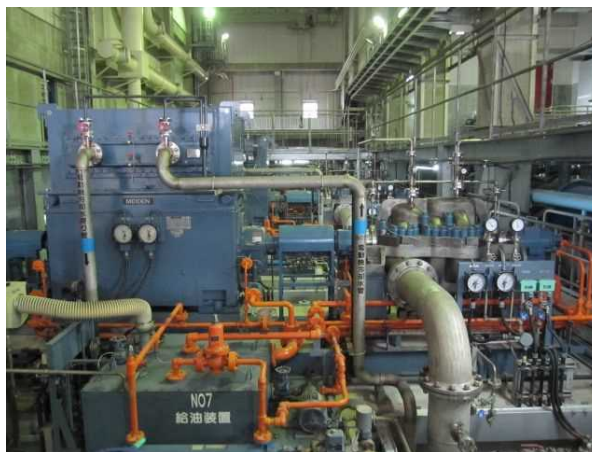
動力回収タービン(海水淡水化施設)
