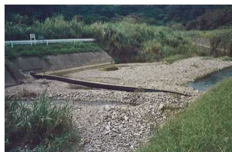
取水堰の堆積土砂状況
