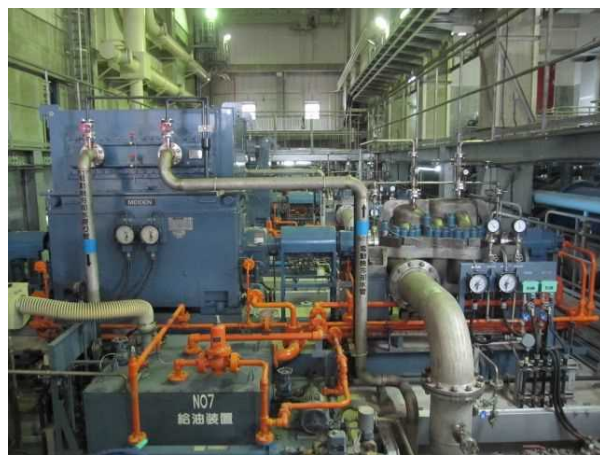
動力回収タービン(海水淡水化施設) ＜動力回収タービンの緒言＞
