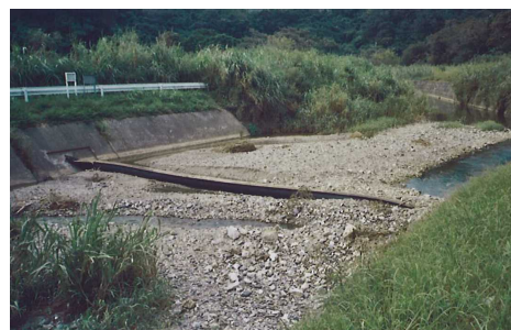
取水堰の堆積土砂状況
