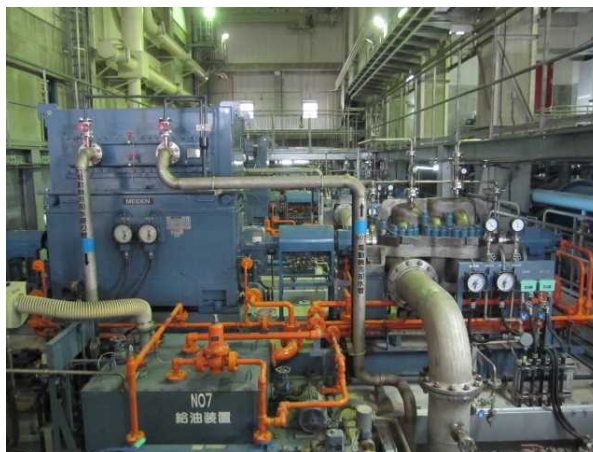
動力回収タービン(海水淡水化施設) <動力回収タービンの緒元> ・回収動力：386kW ・回収率：約30%
