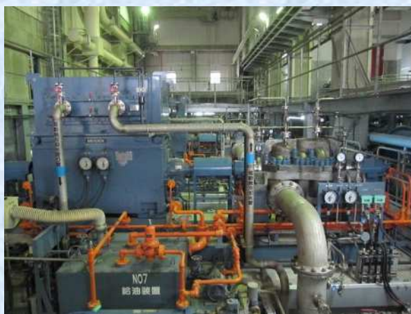
動力回収タービン(海水淡水化施設)
