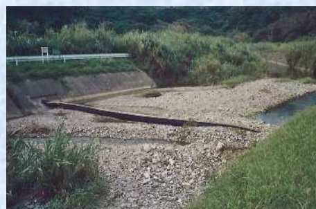
取水堰の堆積土砂状況
