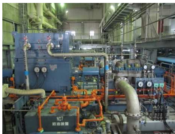
動力回収タービン(海水淡水化施設)
