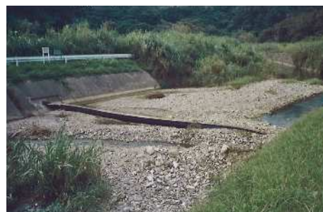
取水堰の堆積土砂状況
