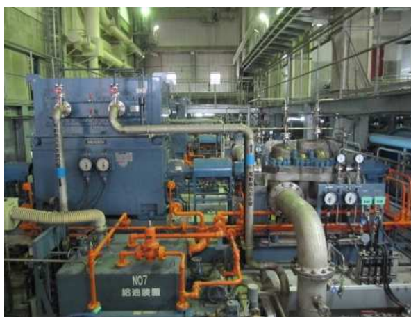
動力回収タービン(海水淡水化施設)
