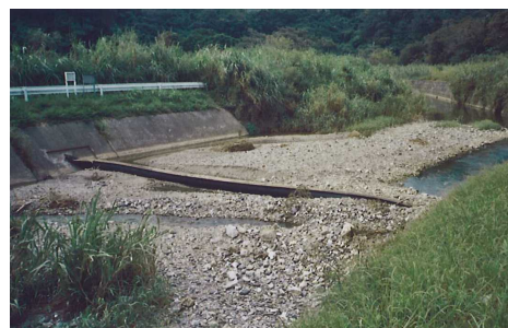
取水堰の堆積土砂状況
