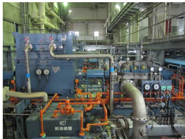
動力回収タービン(海水淡水化施設)
