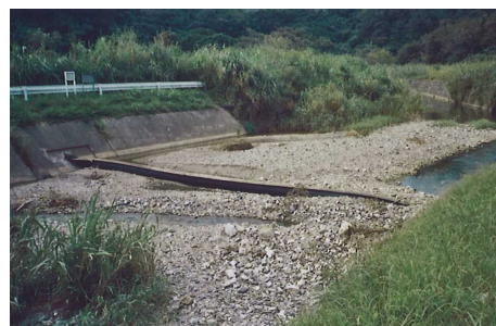
取水堰の堆積土砂状況
