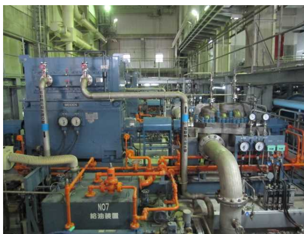
動力回収タービン(海水淡水化施設) <動力回収タービンの緒元>
