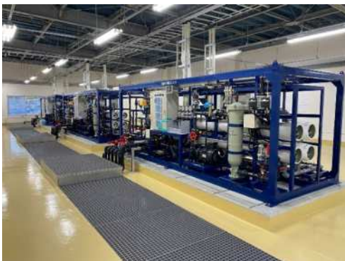
離島海水淡水化施設（北大東村）
