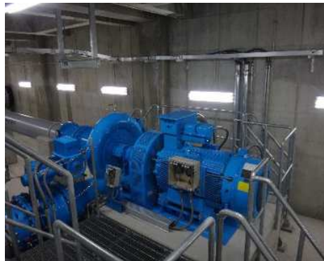
大湾小水力発電設備
