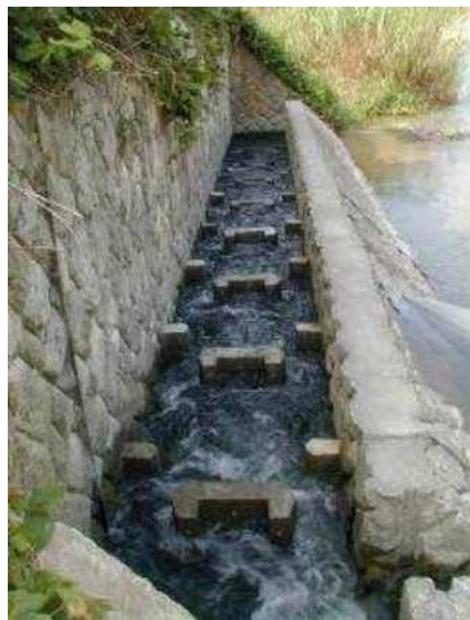
取水施設に設置した魚道
