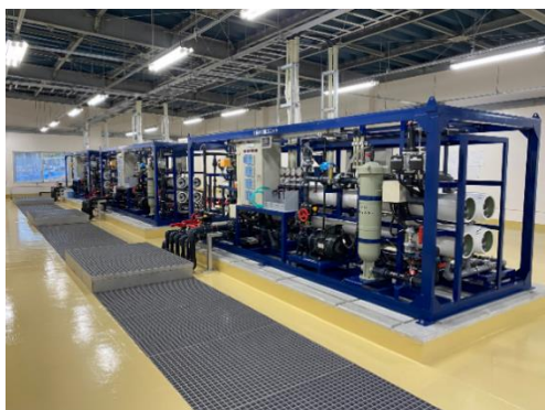
離島海水淡水化施設（北大東村）
