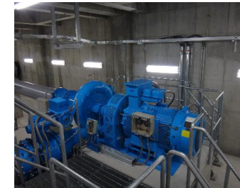
大湾小水力発電設備
