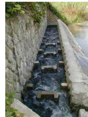
取水施設に設置した魚道
