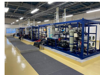
離島海水淡水化施設(北大東村)
