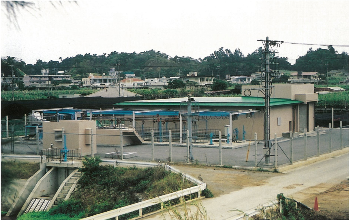
我部祖河取水ポンプ場
