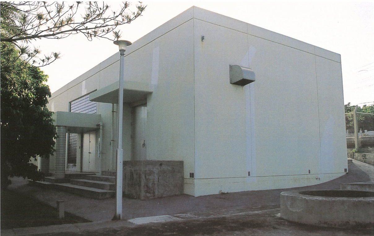
小那覇増圧ポンプ場
