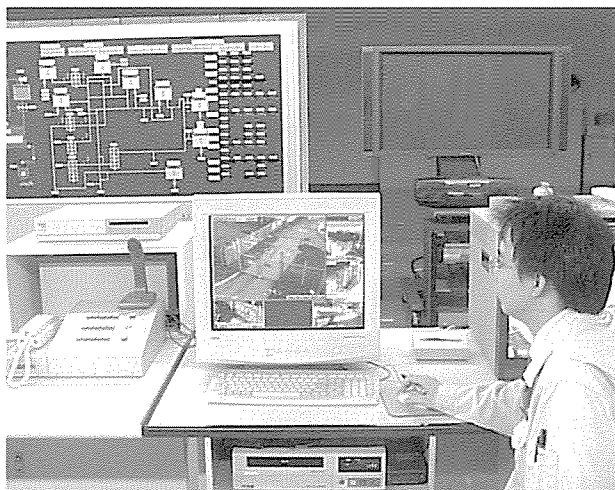
浄水場における監視
