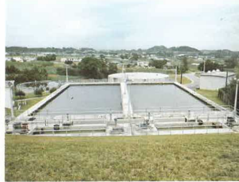
薬品沈でん池
