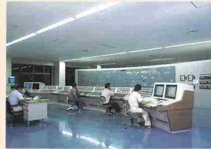
中央管理室 日夜、職員が浄水処理業務にあたっている。
