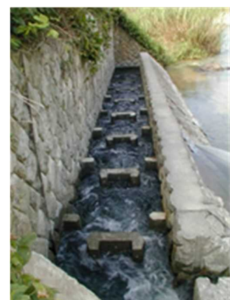
取水施設に設置した魚道
