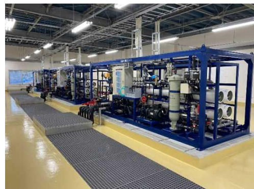
離島海水淡水化施設(北大東村)
