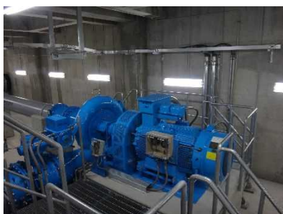
大湾小水力発電設備
